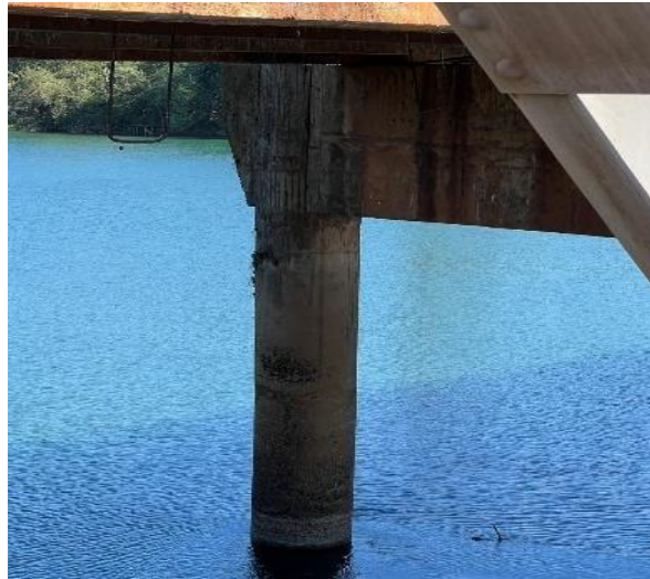
Figura 10 – Pilar e Viga com marcas de lixiviação
