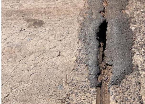
Figura 5 – Fissuras por possível retração no concreto
