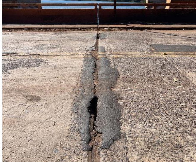
Figura 11 – Junta de dilatação danificada entre tabuleiros
